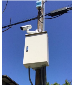
木津川市設置例
